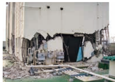
東日本大震災での工学研究科の建物被害
